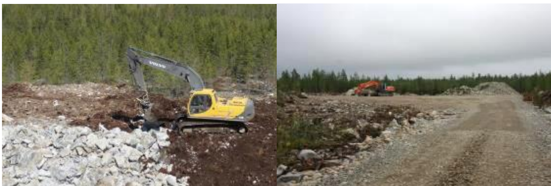
Bildpar 5.9. Byggandet av vindkraftsparken inleds med att bygga vägar och service-/resningsområden. (bilder: Ville Suorsa, FCG).
