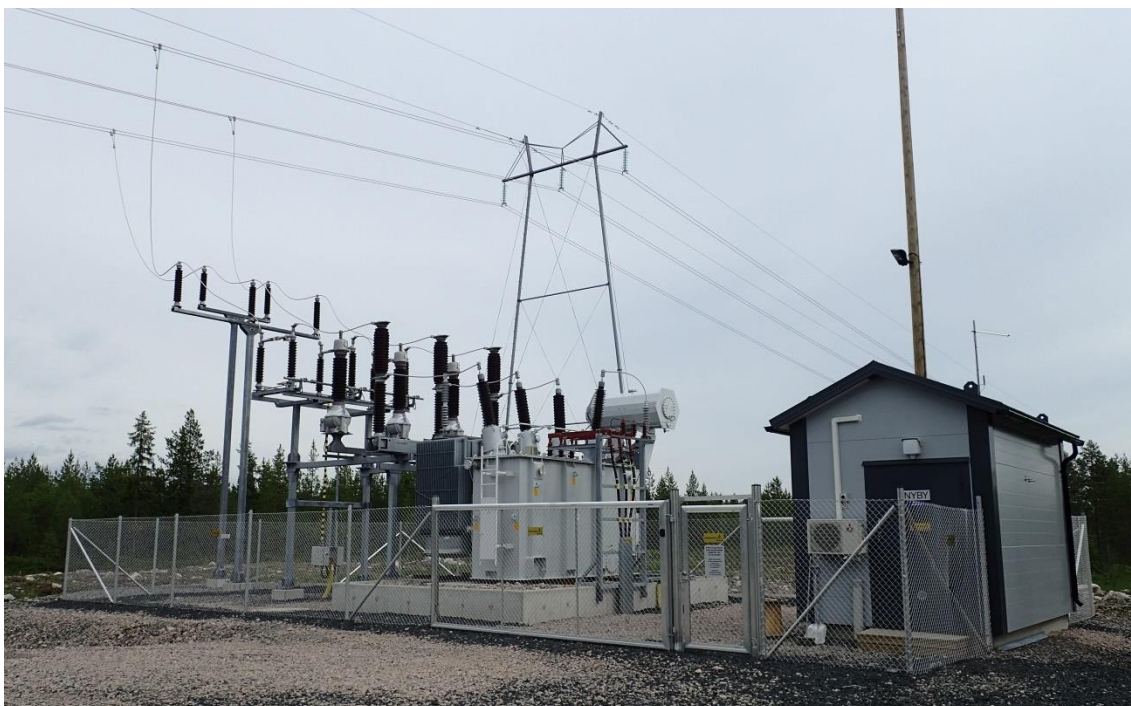
Bild 5.7. Exempel på en elstation i en vindkraftspark (foto: Minna Takalo/FCG).
