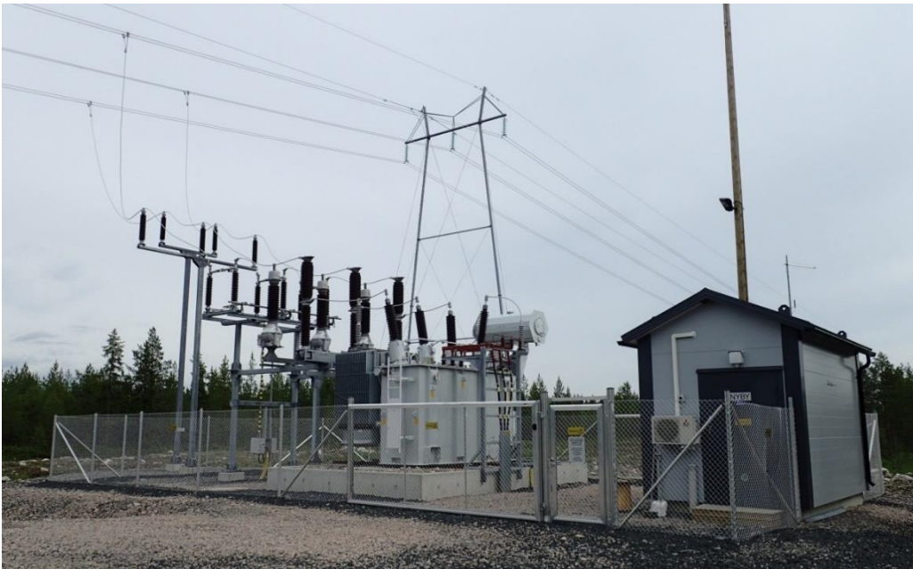
Bild 85. Exempel på en elstation i en vindkraftspark (Minna Takalo, FCG).
