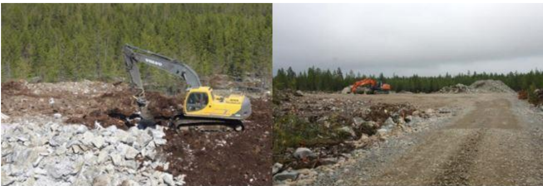
Bild 87. Byggandet av vindkraftsparken inleds med att bygga vägar och service-/resningsområden. (Ville Suorsa, FCG).
